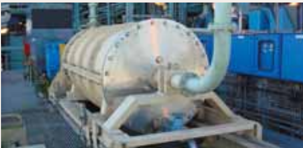
Figura 1: El M3000 IsaMill instalado en Lonmin, Sudáfrica.
