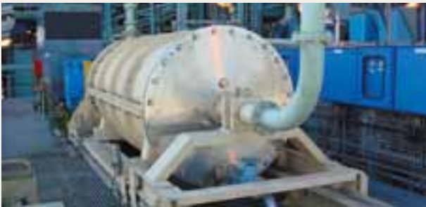
Figura 1: El M3000 IsaMill instalado en Lonmin, Sudáfrica.
